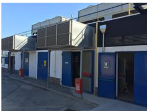
Figura 9 - impianto di produzione energia elettrica.
