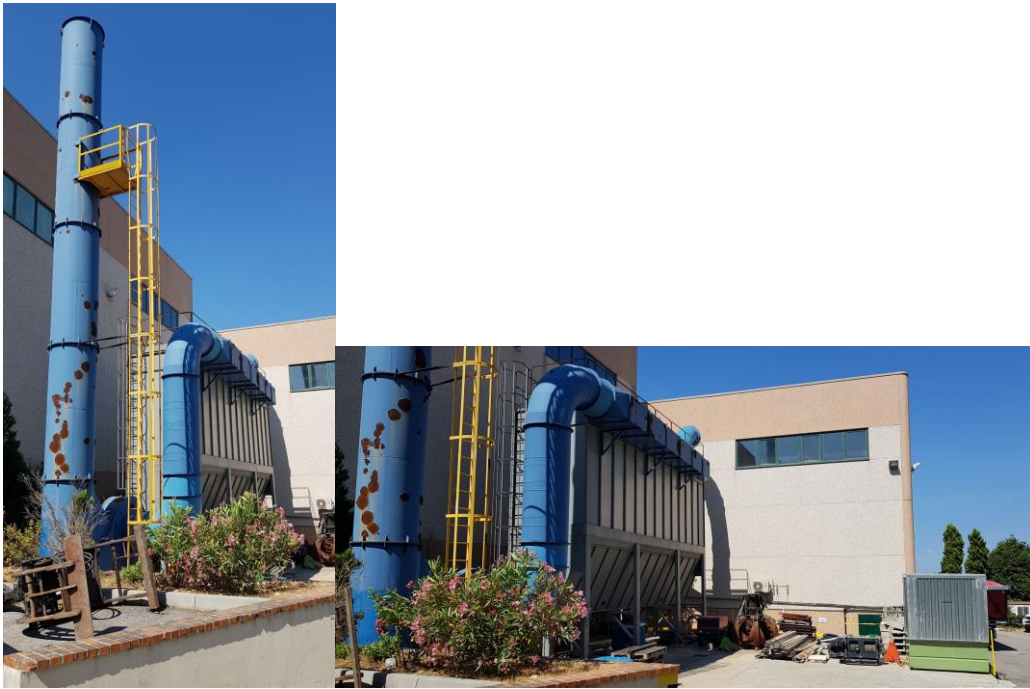
Figura 16 - Foto filtro maniche
