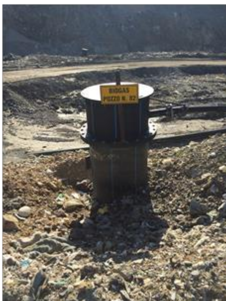
Figura 7- pozzo di captazione biogas
